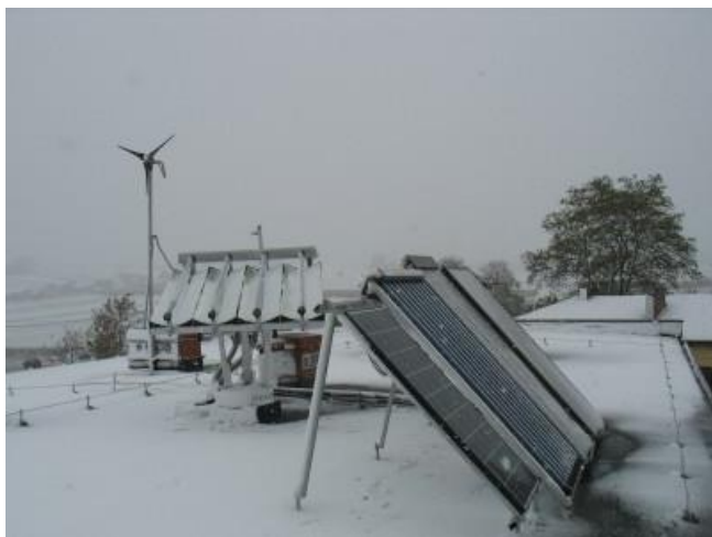
Fot. 17. Instalacje solarne i turbina wiatrowa w Centrum Energii Odnawialnej w Pojałowicach.
