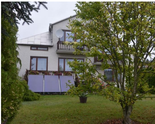
Fot. 18. Instalacje solarne na budynku mieszkalnym.
